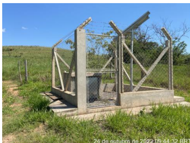
Foto 1 – Estação sismológica da Barragem Duas Pontes (Data:24/10/2022)
