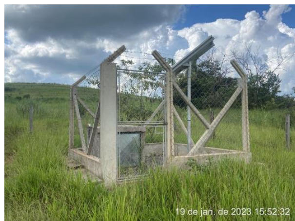
Foto 4 – Estação sismológica da Barragem Duas Pontes (Data: 19/01/2023)
