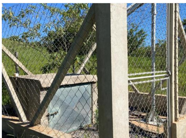
Foto 3 – Estação sismológica da Barragem Duas Pontes (Data:16/12/2022)
