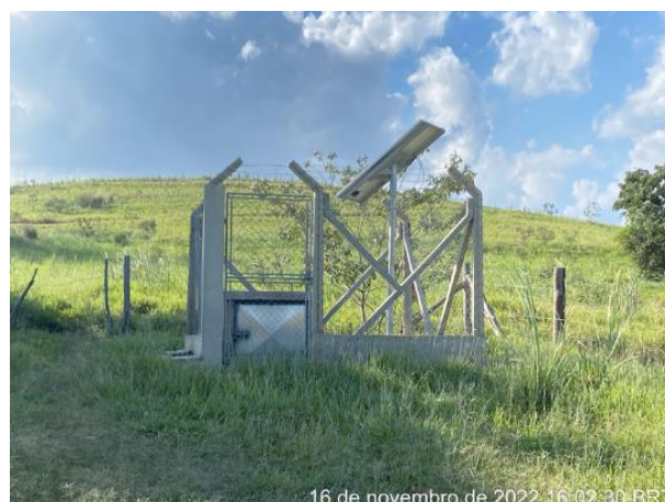
Foto 2 – Estação sismológica da Barragem Duas Pontes (Data 16/11/2022)
